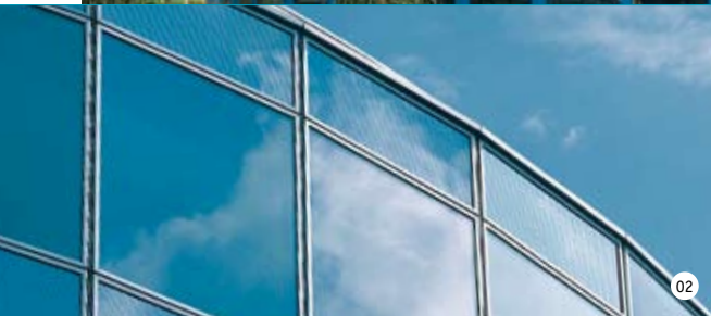
01. In den Rundungen des Free Record Shops in Capelle spielt die Fassadenplatte DELOGCOLOR® in Weiß ihre faszinierende Wirkung aus. 02. Ziel erreicht: Die perfekt gestaltete Ganzglasfassade mit DELOGCOLOR® DESIGN-Lochdekorbedruckung, VKV Saarbrücken.
